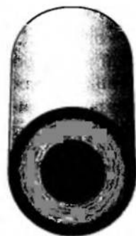
Рис. 21.6. Накипь на стенках старой трубы водяного отопления
